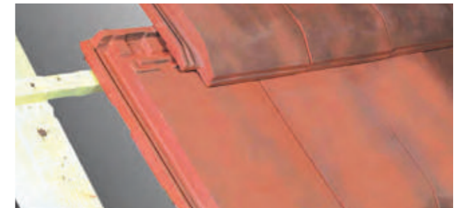
Fixation des tuiles du 1 er rang d'égout par crochet «PM» Réf. CRP03.
