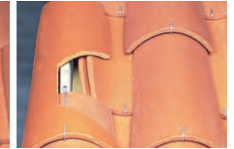
Fixation des tuiles en rives latérales gauche et droite par crochets «S» à raison de : 1 crochet «S» sur 2 tuiles.
