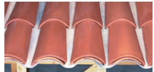
Mise en œuvre traditionnelle (1 tuile) en pose à "joints droits". Les tuiles CANAL Poudenx sont posées à recouvrement sur les sommets de onde des plaques.
