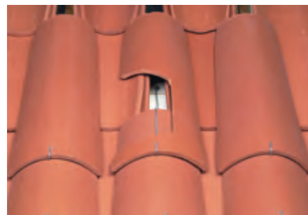
Fixation des tuiles de couvert en plain carré par crochets «S» à raison, sur 10 crochets : 8 crochets «S»
