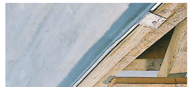
Mise en place de la noue métal façonnée à relevés, contre liteau filant et patte de fixation.
