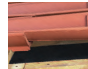
Fixation des tuiles de courant en plain carré par les tenons des tuiles. La fixation en référence au tableau n° 5 du DTU 40.22 art. 3.333 est assurée par les tenons des tuiles.
