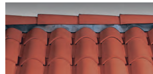
Faîtiage réalisé à sec avec faitière à sec sans emboîtement et closoir ventilé, sans emploi de mortier.
