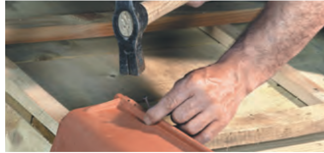
Fixation des rives rondes individuelles à emboîtement en rive latérale gauche et droite par vis et rondelle d'étanchéité.
